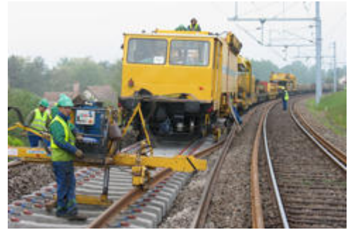
Longs Rails soudés sur traverses béton
